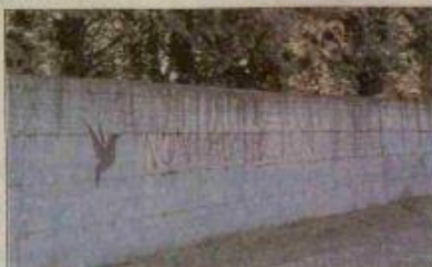
L'un des tags sur le mur de clôture de La Grande Bastide.
